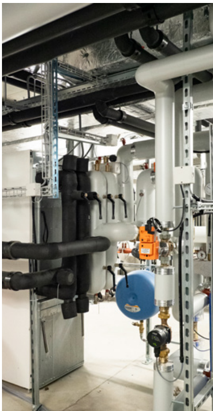
Aufwendige Gebäudetechnik für komfortables Wohnen.
