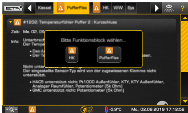
Abb. 2-10: Auflistung der Fehler
